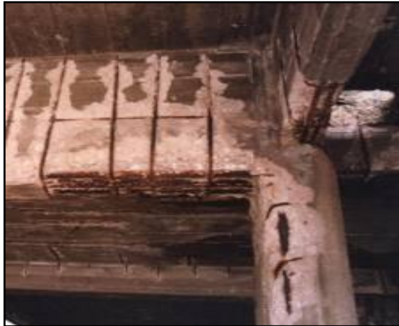
Figura 2. Estructura de hormigón armado cuyas barras de acero se han oxidado
