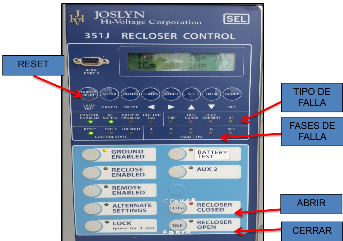
FIGURA 2-A, Tablero de control del Reconector de Barras
