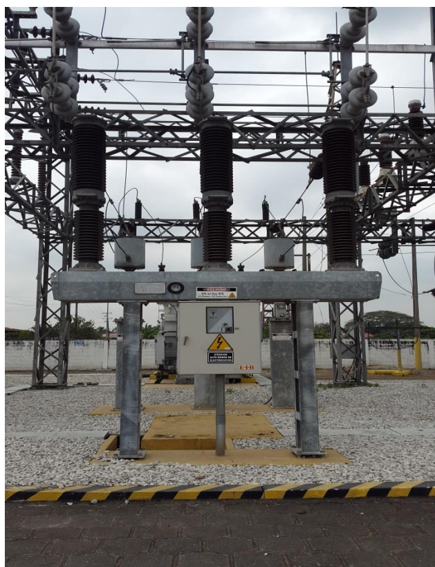
FIGURA 7. Disyuntor de tipo SF6 MONTERO NARANJAL
