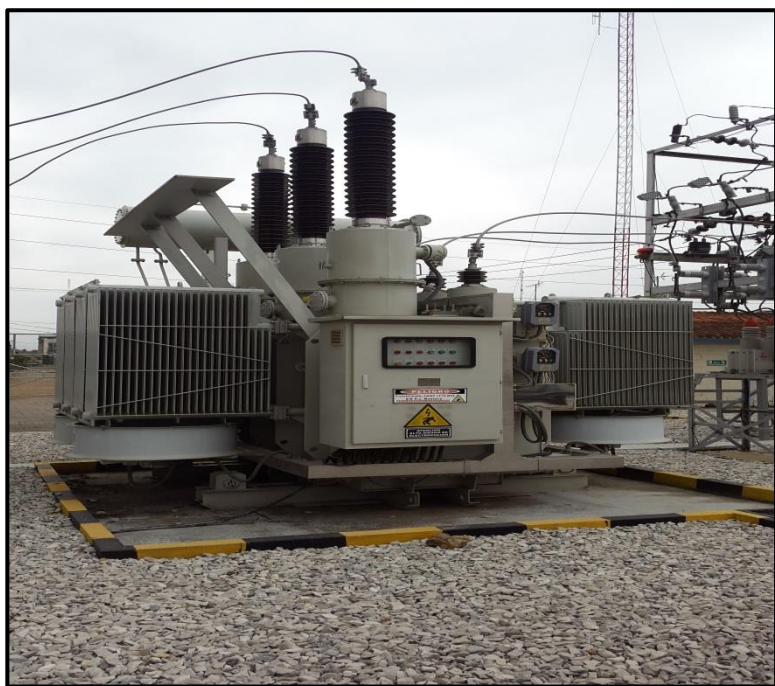
FIGURA 01, Transformador de Poder Osaka Chint
