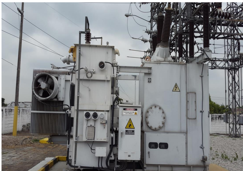
FIGURA 04, Transformador de Poder Mitsubishi
