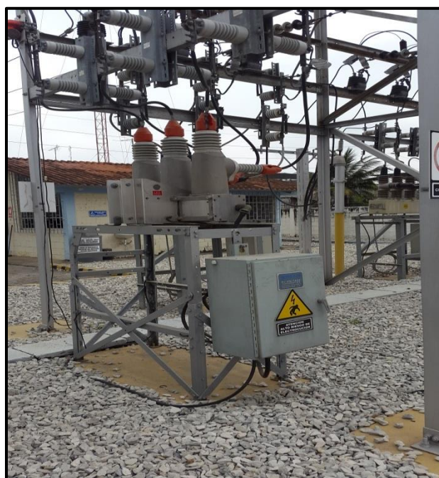
FIGURA 2, Reconector de Barras Salida del Transformador de Poder OSAKA CHINT
