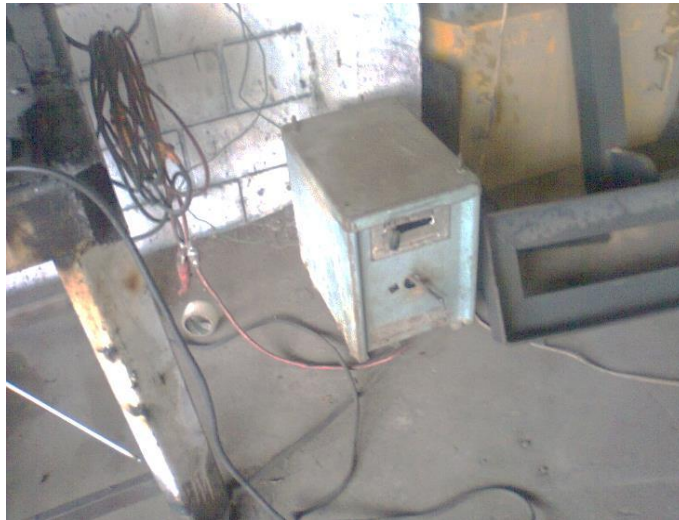
Figura 2. Máquina de soldar en condiciones inseguras
