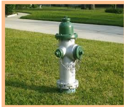
Figura # 37 Boca de Incendio
