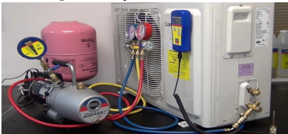
Imagen No. 3 Compresor en el aire acondicionado
