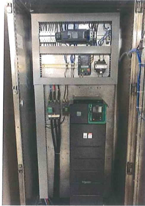
Figure 3.- Elementos de tablero de control EB María Teresa
