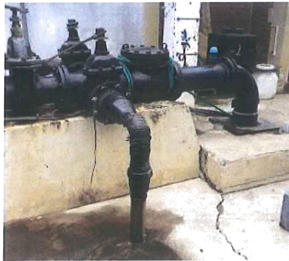
Figure 12.-Tubería de succión y descarga EB Sur
