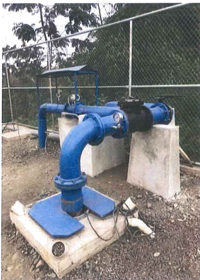
Figure 5.- Tubería de succión y descarga EB Banco de Arena #3
