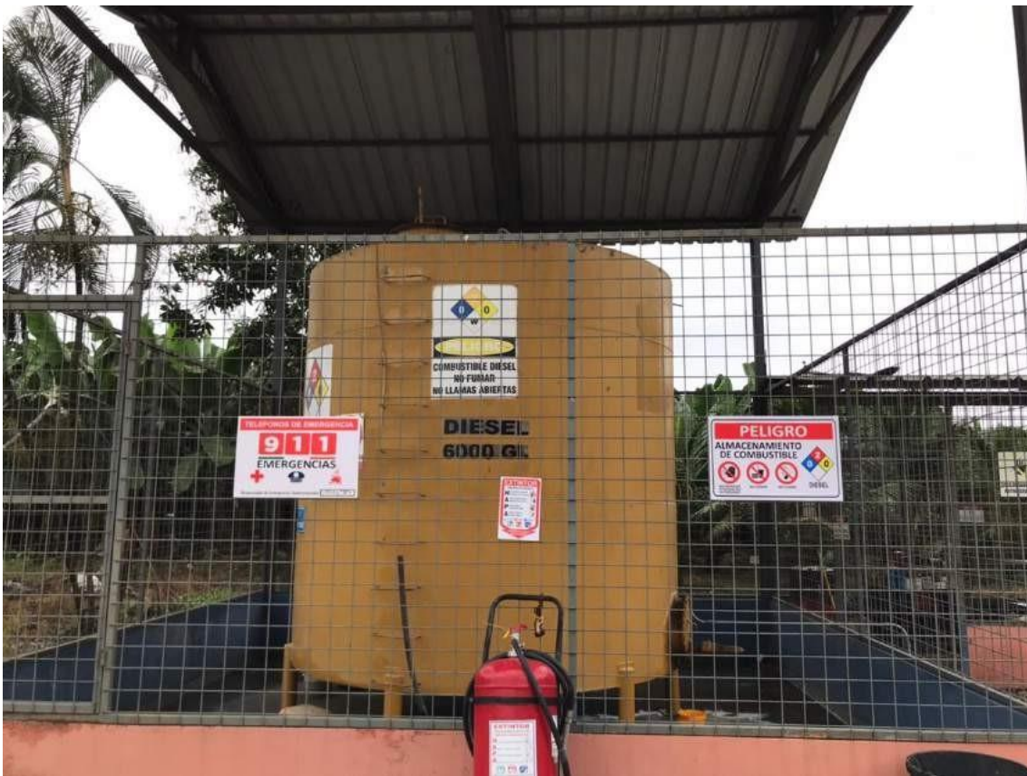
Ilustración 32 Galpón para el almacenamiento de Diésel combustible
