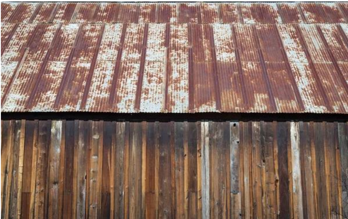
Figura 10. Cubiertas corroídas por el paso del tiempo.
