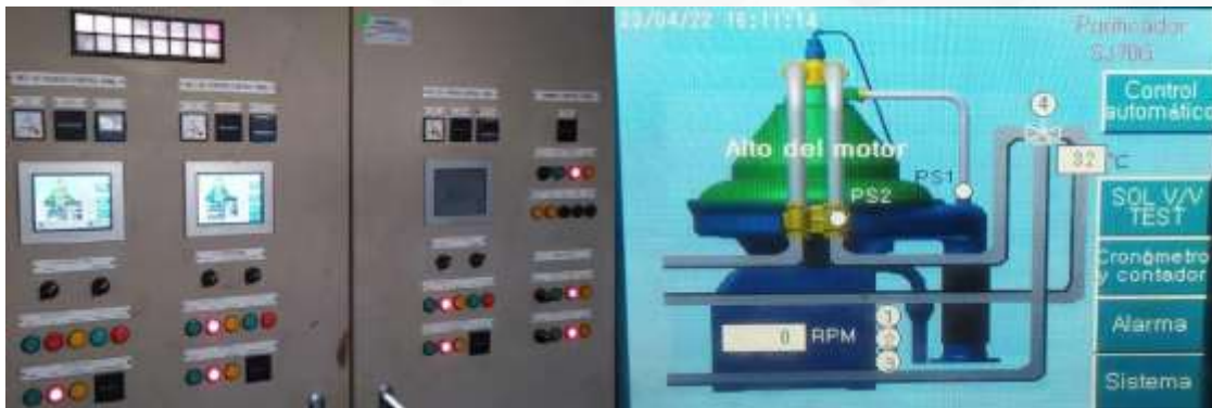
Anexo 10. Tablero de control Purificadoras de diesel
