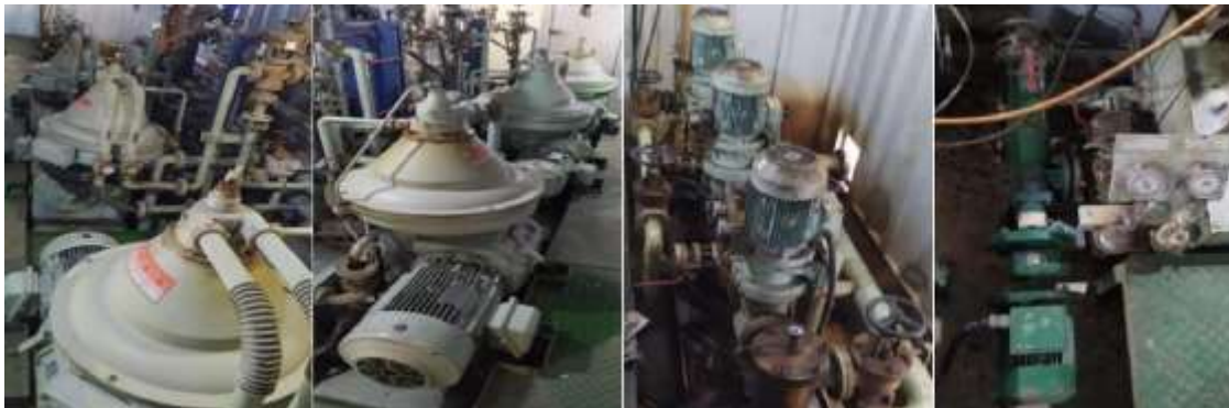
Anexo 12. Cuarto de purificadoras de diesel
