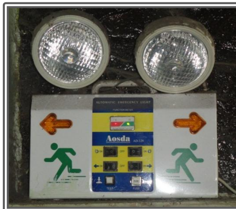
Figura 21. Equipo de emergencia automático.
