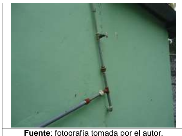
Figura 5. Llaves de procesos sin capuchas de seguridad.
