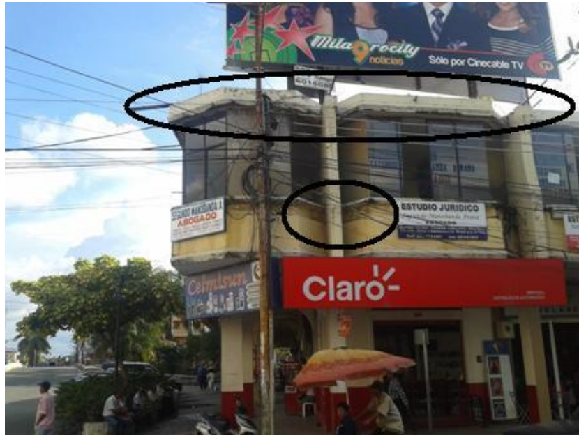
Figura 12: Foto de local esquinero, se puede apreciar el deterioro y falta de limpieza del inmueble, que perjudica la imagen de los locales allí ubicados.
