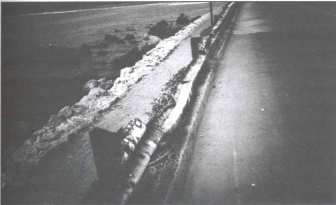
Figura 1. Barreras camineras corroídas en camino costero.
