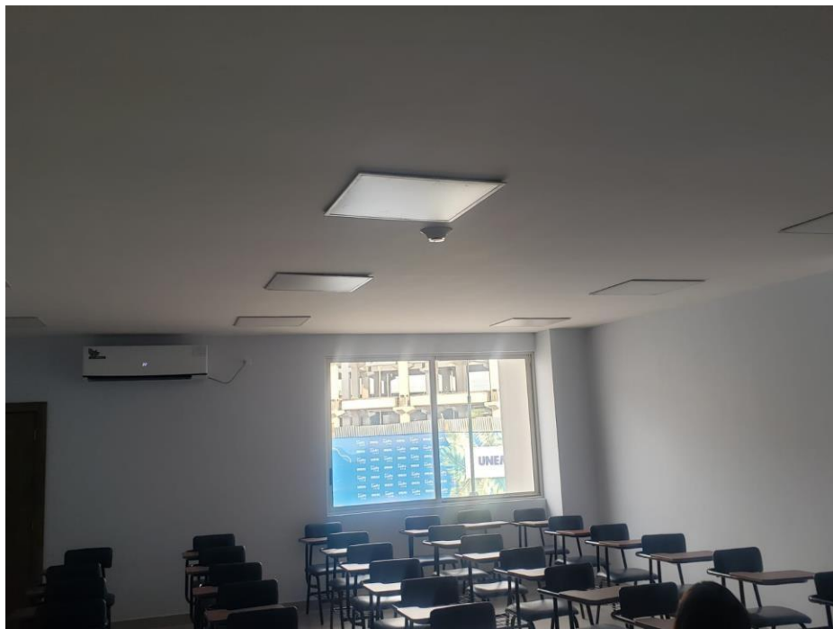
Figura 7. Antena wifi. Fuente: Autoría Propia
