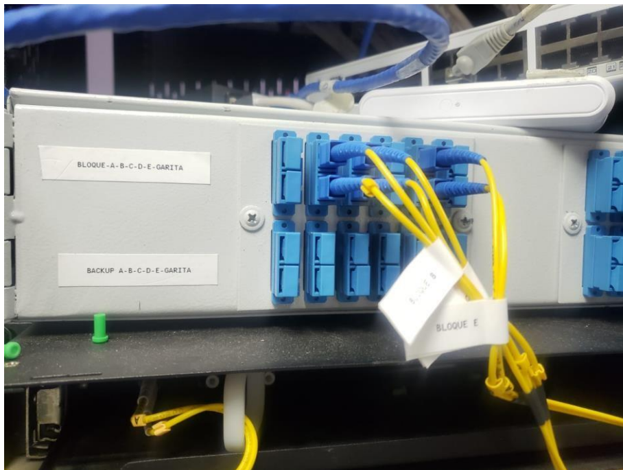
Figura 5. Switch principal. Fuente: Autoría Propia
