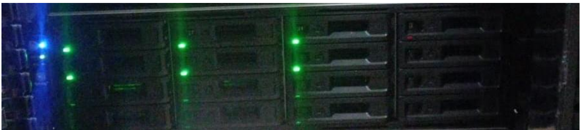
Ilustración 9: Servidor DELL ESXI 7
