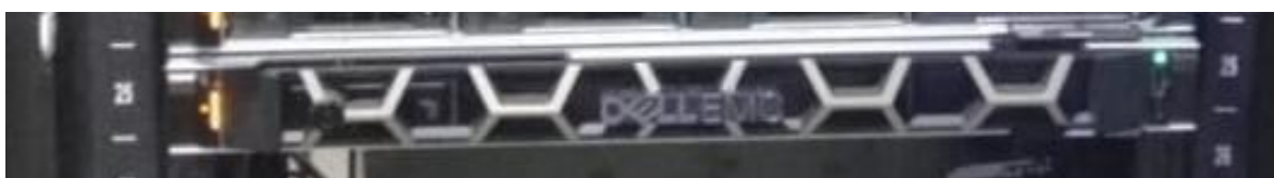
Ilustración 12: Servidor DELL ESXI 10
