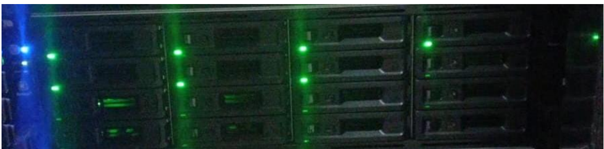
Ilustración 10: Servidor DELL ESXI 8
