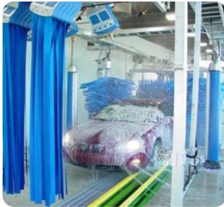
Figura 1. Túnel de Lavado
