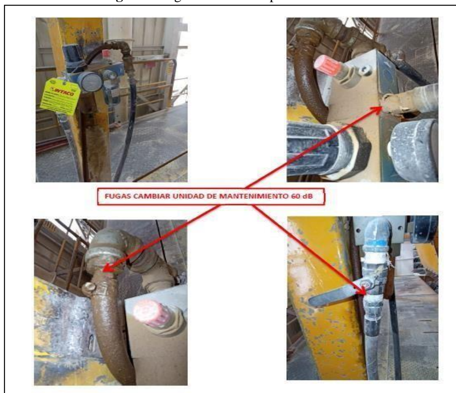
Figura 3 Fuga de aire en acople válvula 60 d.
