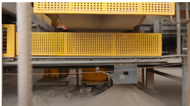
Figura 5. Área descarga de dosificador de clinker/ Observe el polvo alrededor
