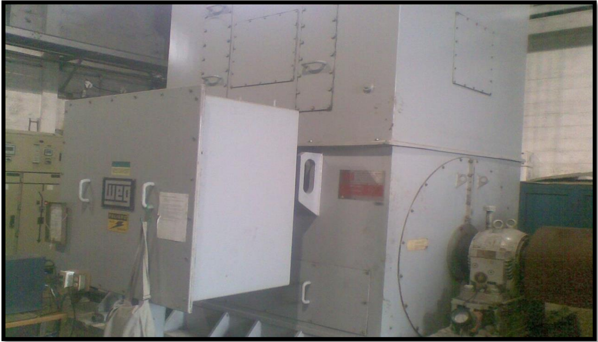
Figura 5. Generador turbogenerador número 2.
