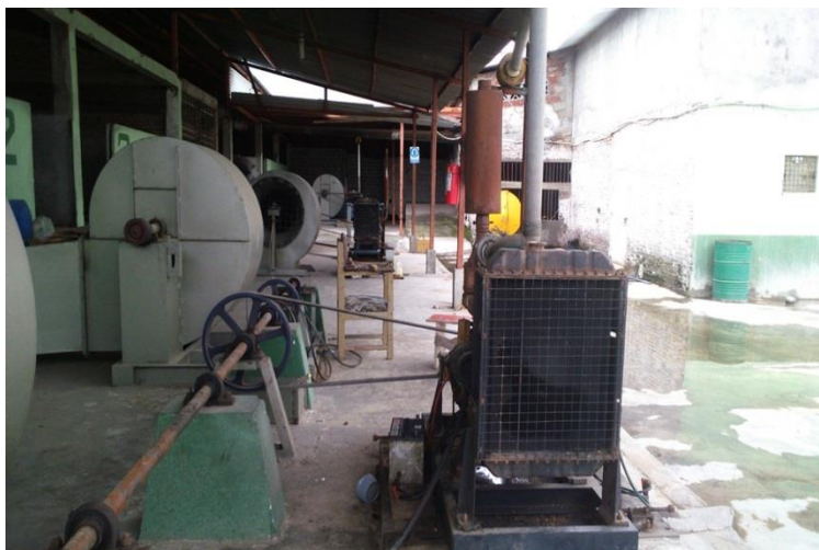
Descripción: Falta de Guardas Fuente: Villamar - Mullo
