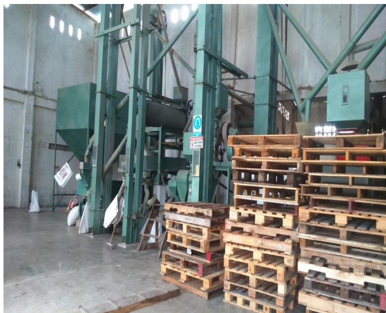
Descripción: Falta de orden y Limpieza Fuente: Villamar - Mullo
