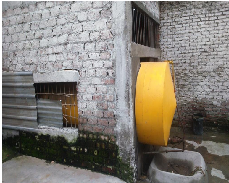
Descripción: Falta de un Dique de seguridad (Protección ante derrame) Fuente: Villamar - Mullo
