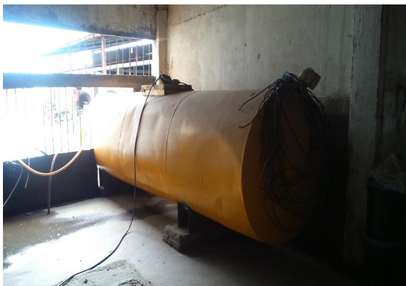
Descripción: Falta kit anti derrame y conexión a tierra Fuente: Villamar - Mullo
