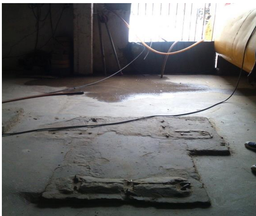
Descripción: Posible riesgo Eléctrico y de caídas por obstáculo Fuente: Villamar - Mullo
