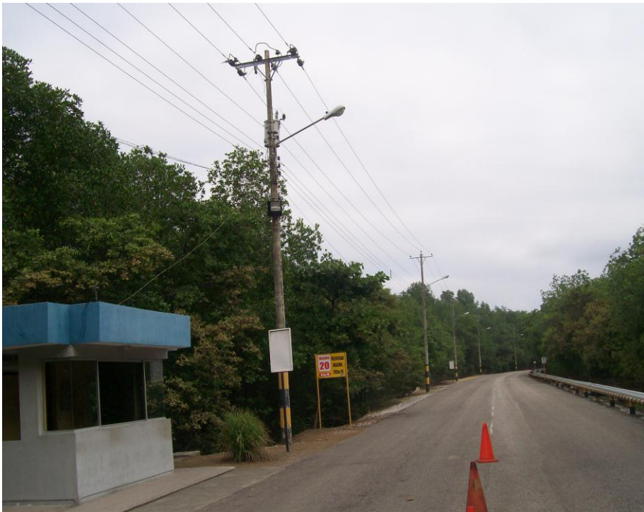
Foto 4- TRANSFORMADOR DE 25 KVA
