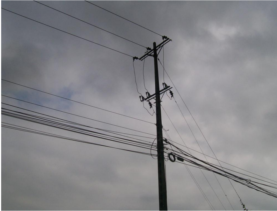
Foto 3- PRIMARIOS EN LA VIA A LA COSTA
