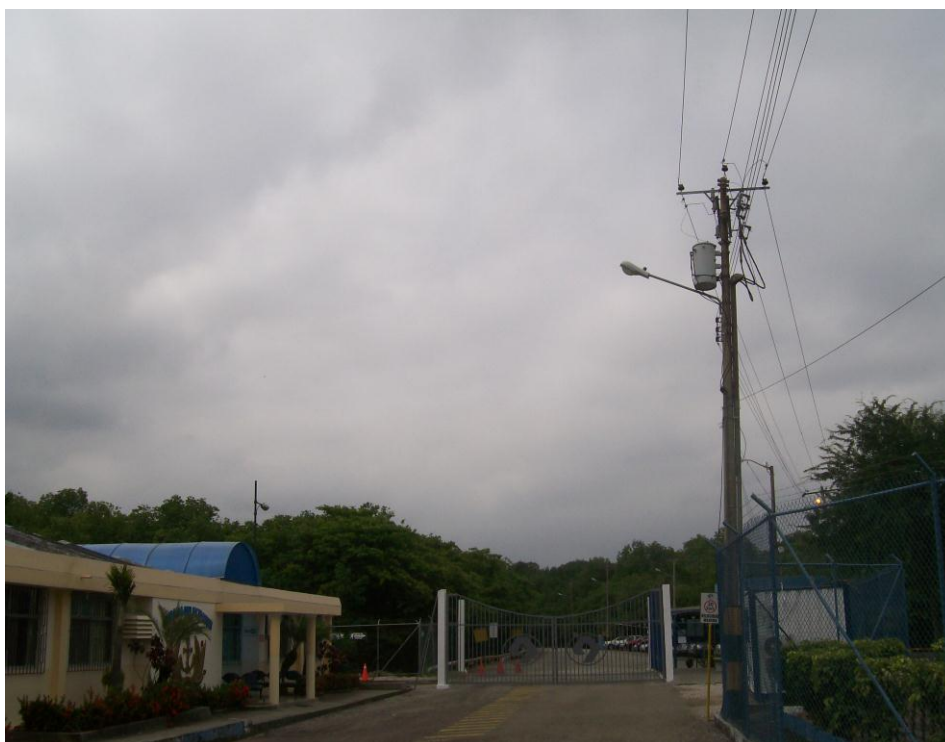
Foto 6- TRANSFORMADOR DE 50 KVA SUINSA
