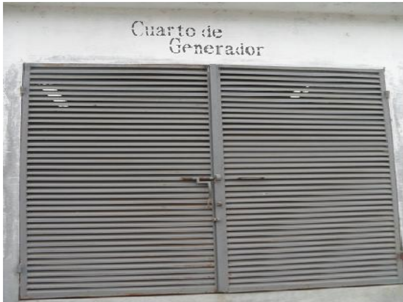
Figura 17. Cuarto de Generadores
