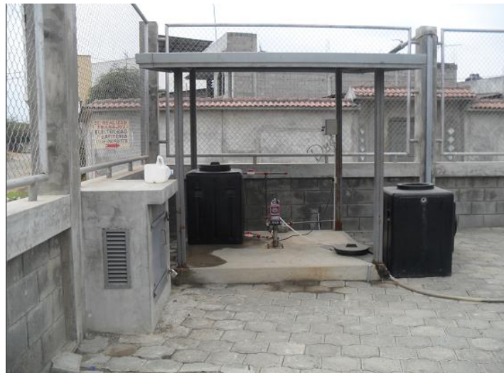
Figura 18. Área de clorificación
