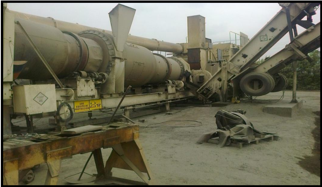
ÁREA DE MEZCLA ASFALTICA
