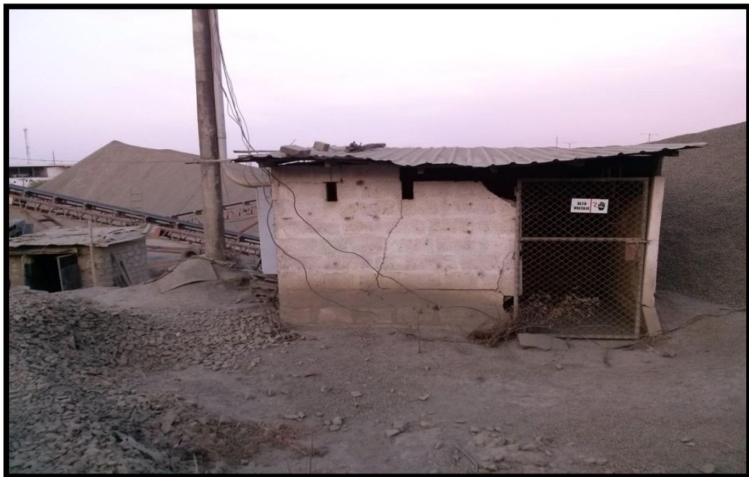
CUARTO DE TRANSFORMADORES
