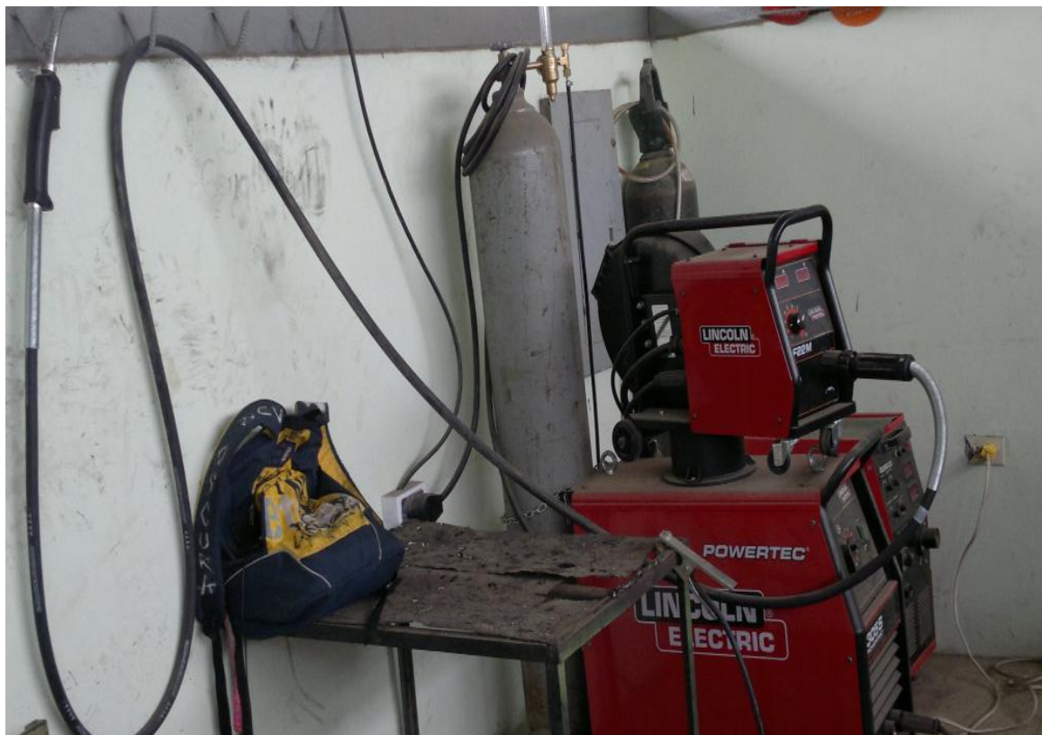
Anexo 7 Taller de ajuste mecánico, almacenamiento de líquidos inflamables junto a panel de breaker
