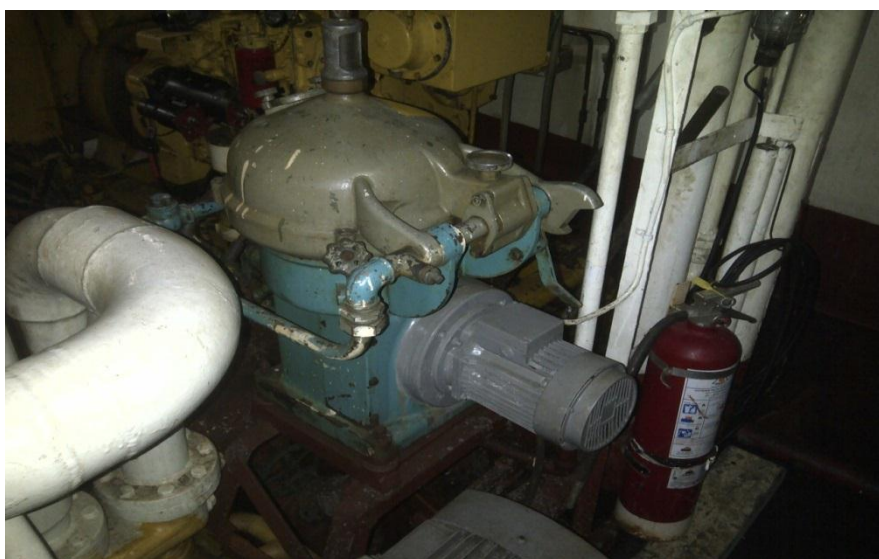
Figura 16. Depurador de combustible
