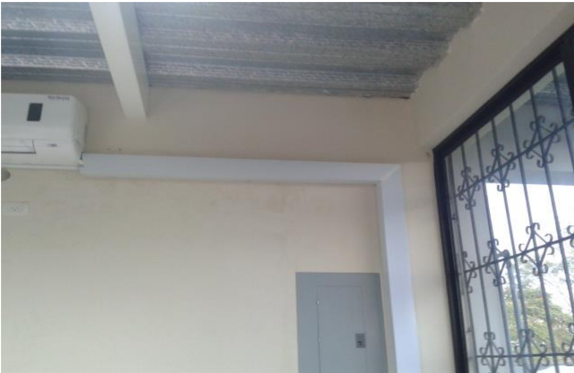
Descripción: Cableado y desagüe del sistema de evaporadoras Fuente: Tomás Robelly y Miguel Robelly
