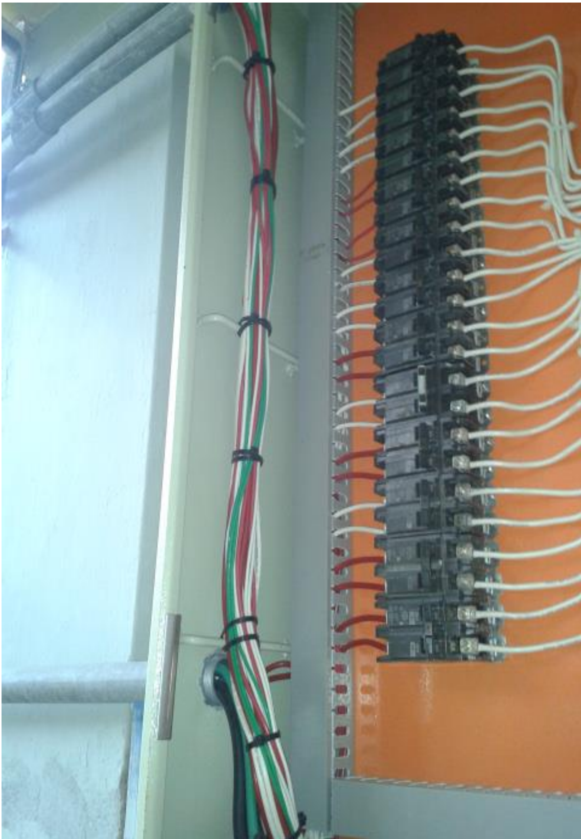
Descripción: Protecciones eléctricas unidades de aires acondicionados Fuente: Tomás Robelly y Miguel Robelly
