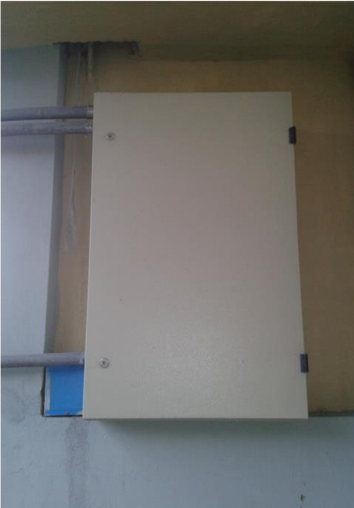
Descripción: Ubicación de tablero eléctrico Fuente: Tomás Robelly y Miguel Robelly
