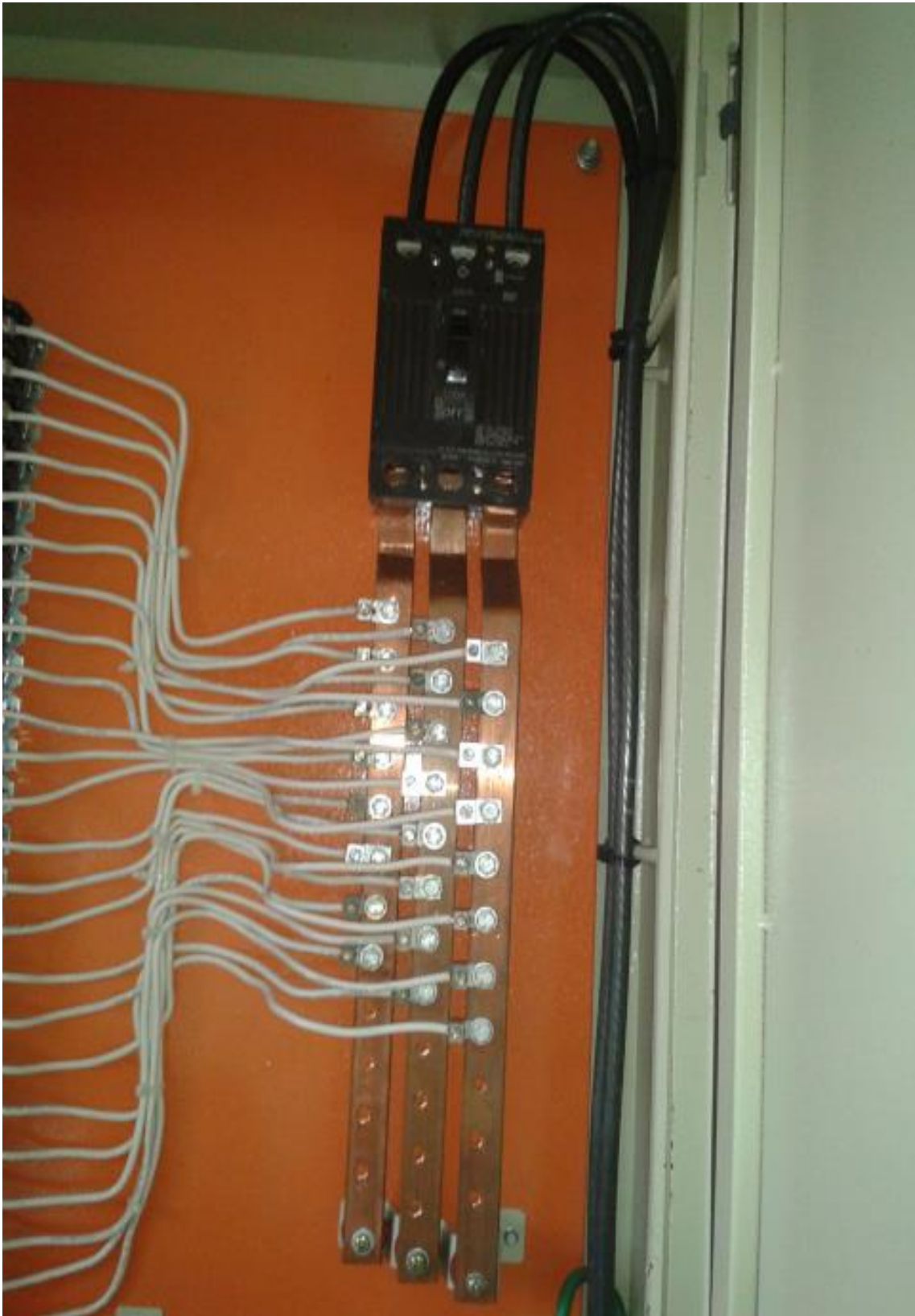
Descripción: Protección Principal del tablero eléctrico Fuente: Tomás Robelly y Miguel Robelly
