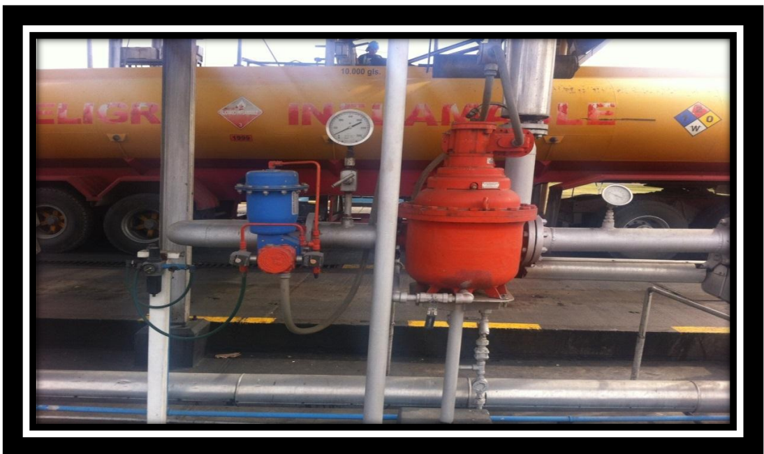
Figura 31: Unidad de Desplazamiento y Válvula automática instaladas.
