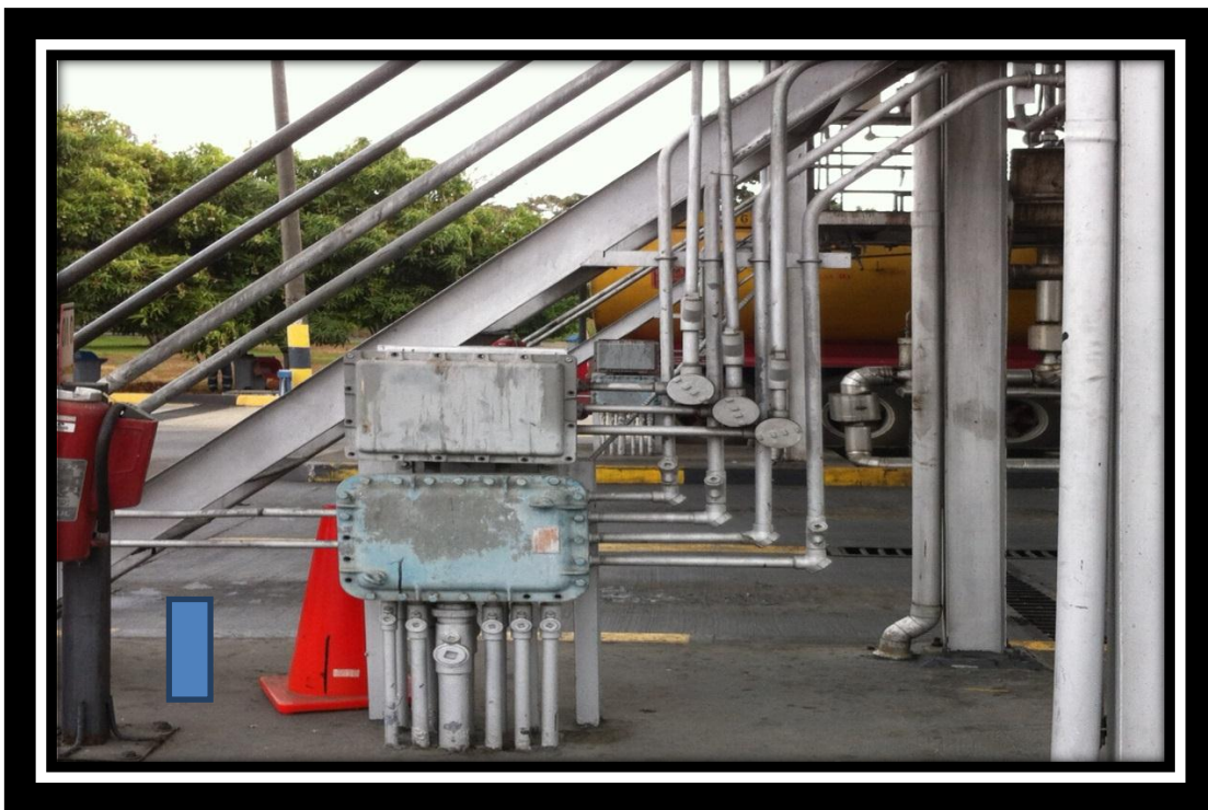
Figura 33: Tablero de Distribución y tuberías.
