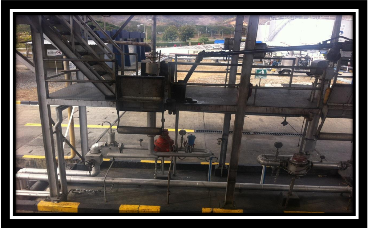
Anexo 18: Vista Superior del Sistema Instalado.
