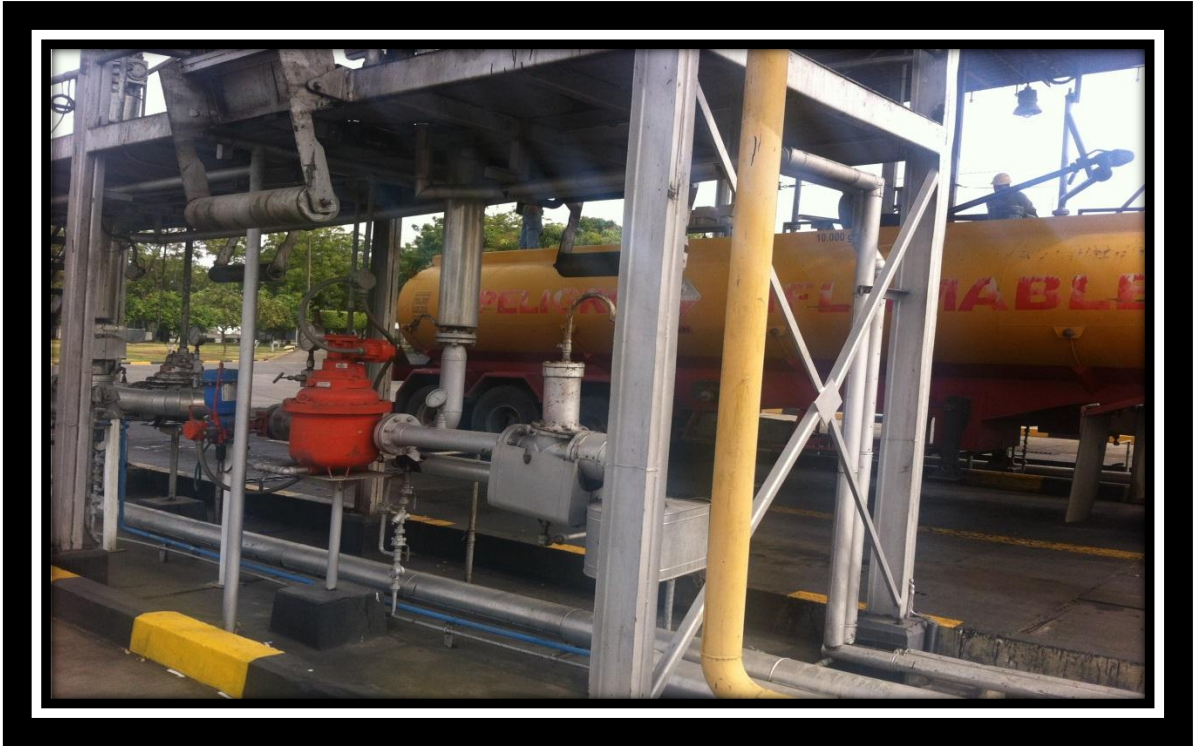
Anexo 16: Vista Frontal del Sistema Instalado.
