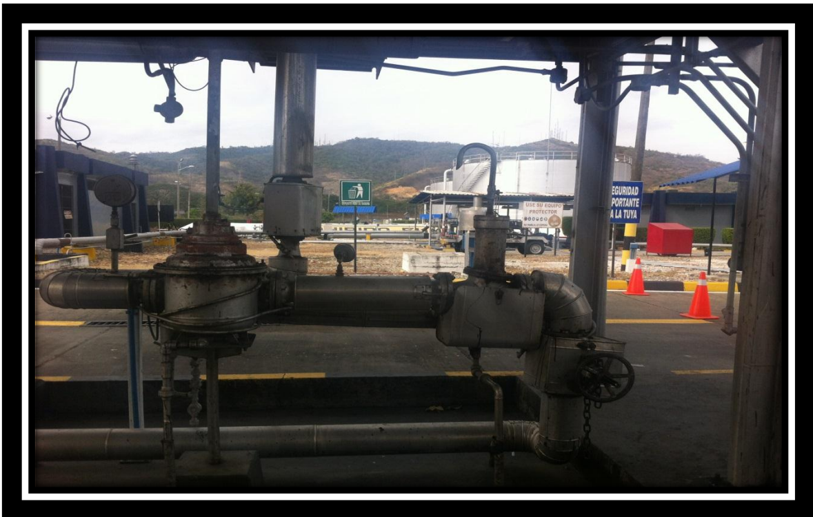
Anexo 10: Unidad de Medida, Filtro y Válvula manual.
