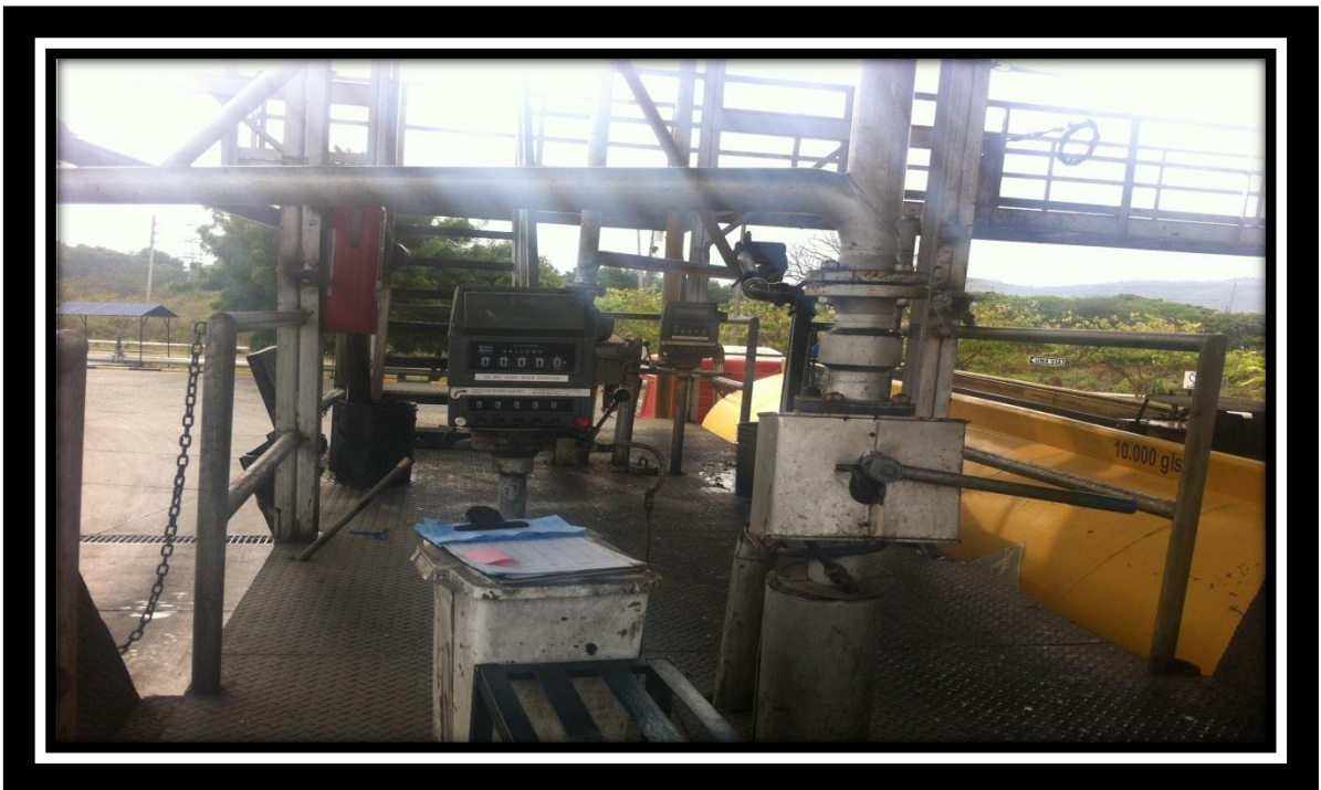
Anexo 12: Impresora manual y válvula de despacho.
