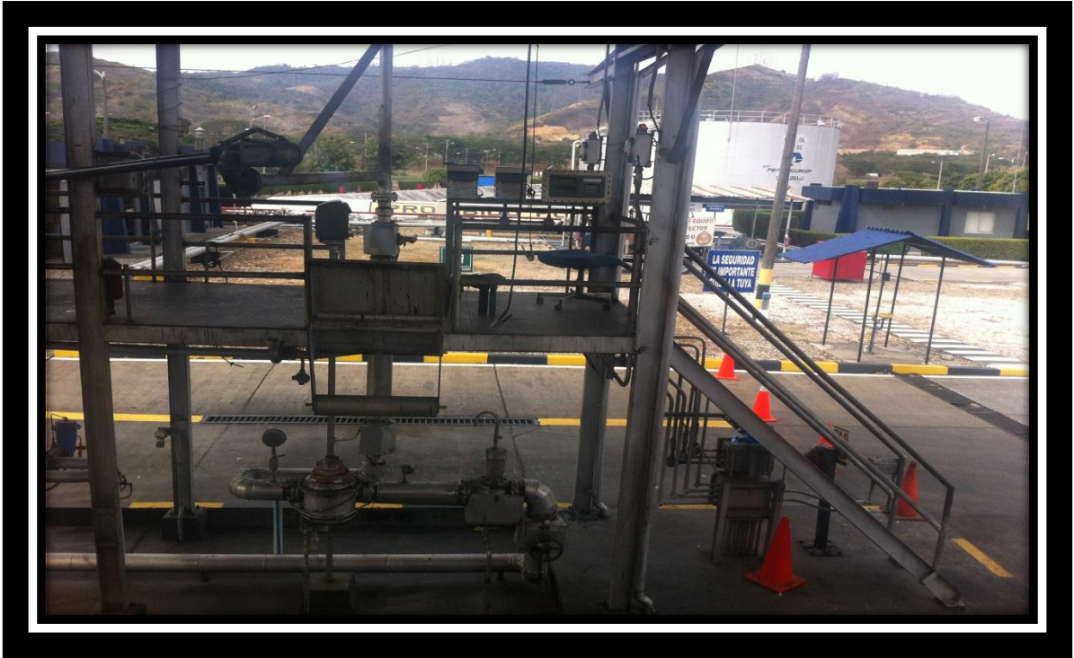
Anexo 11: Sistema de carga Atmosférica completo.
