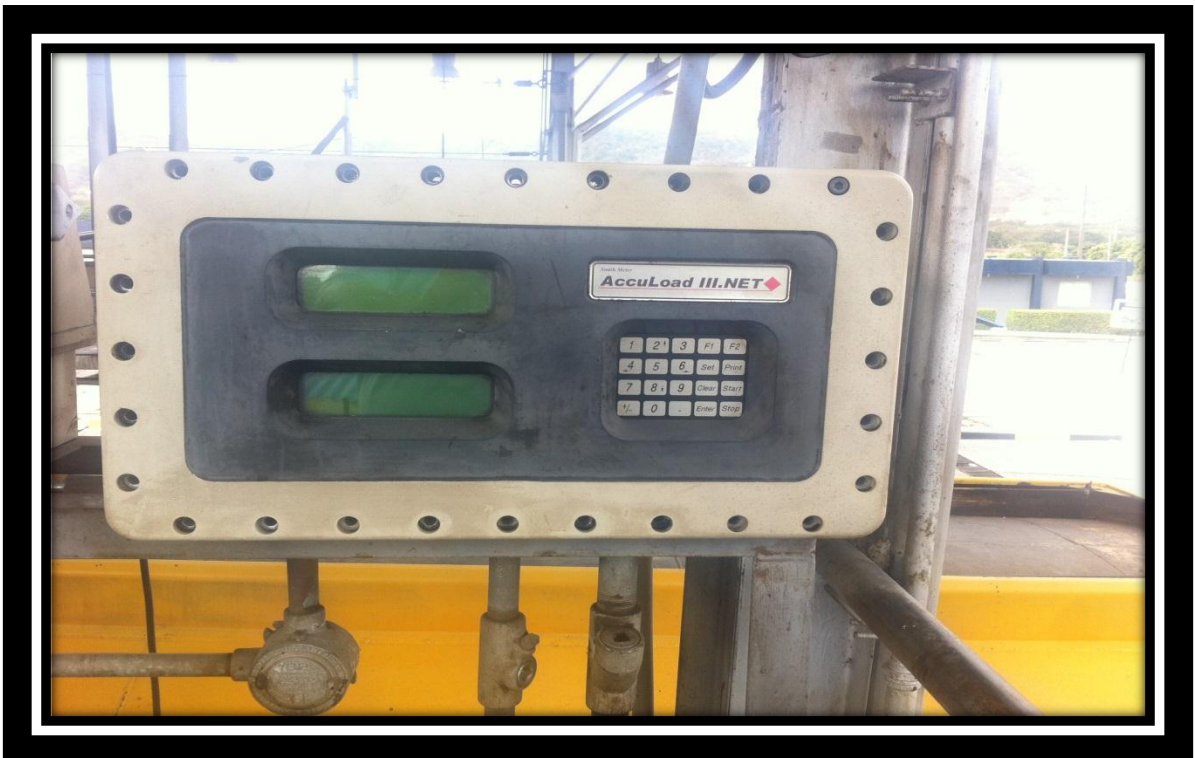
Anexo 19: Accuload III Instalado.
