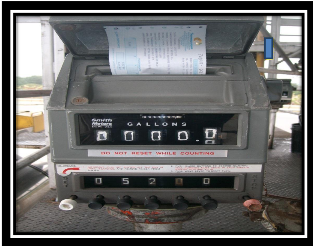
Anexo 1: Contador Manual Smith Meters.
