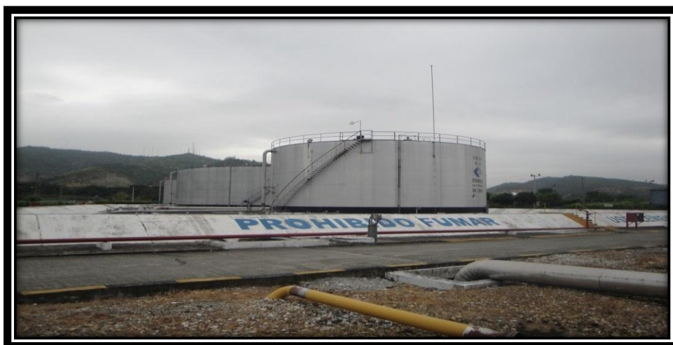
Figura 1: Tanques de Almacenamiento en Terminal Fuel Oil.
