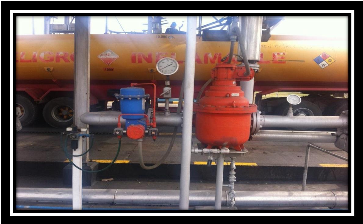
Anexo 15: Unidad de Desplazamiento y válvula automática instaladas.
