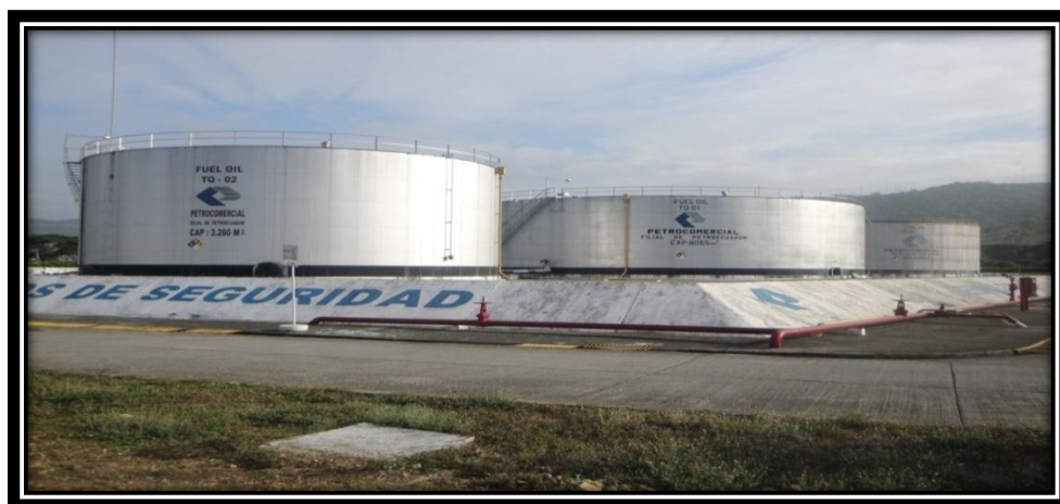
Figura 8: Tanques de almacenamiento en Terminal Fuel Oil.
