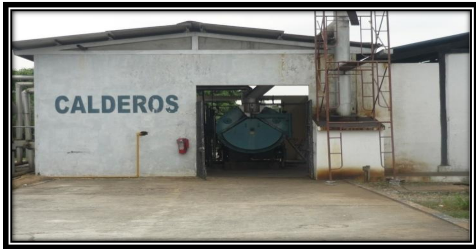
Figura 4: Área de Calderos en Terminal Fuel Oil.
