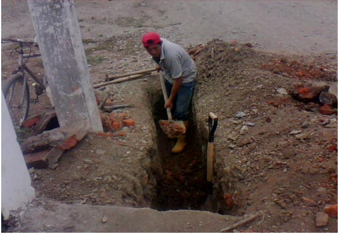
Daño de la tubería en la Parroquia Virgen de Fátima en solución
