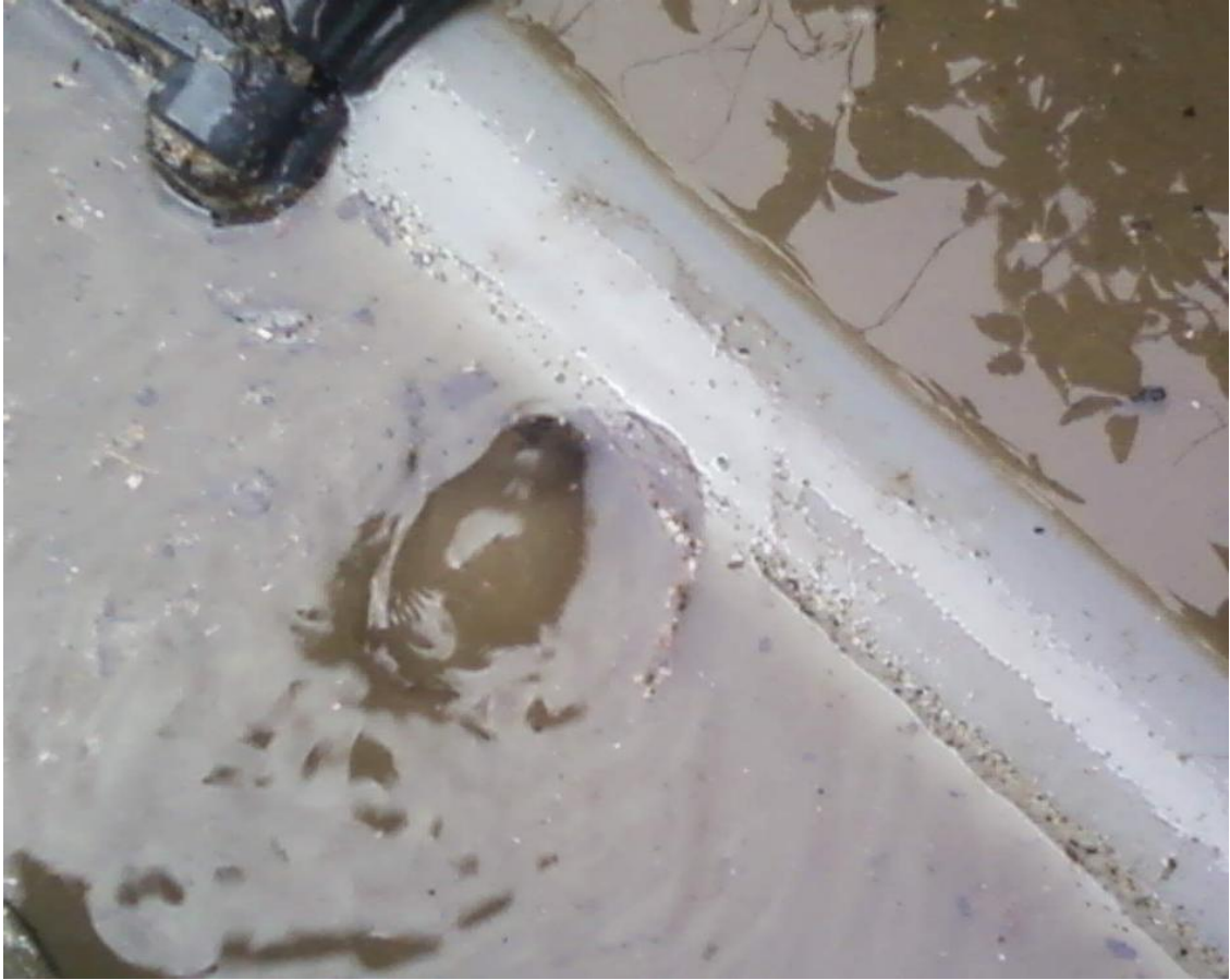
Daño en la tubería de la Parroquia Virgen de Fátima
