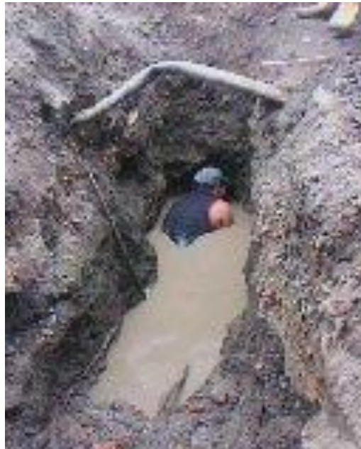
Persona verificando el daño
