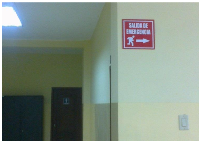
Señalización inadecuada de rutas de evacuación
