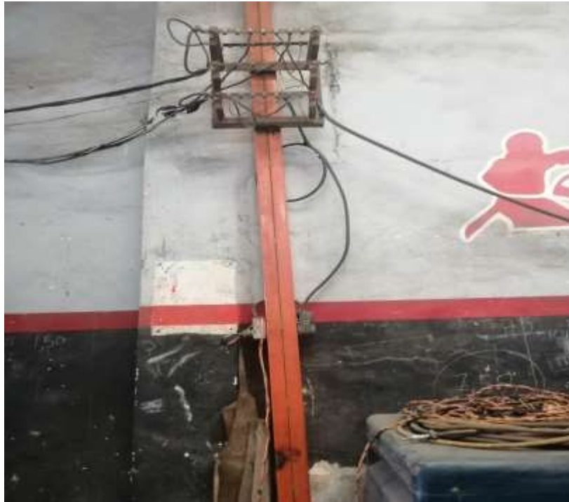
Anexo 3. Sistema eléctrico en mal estado.
