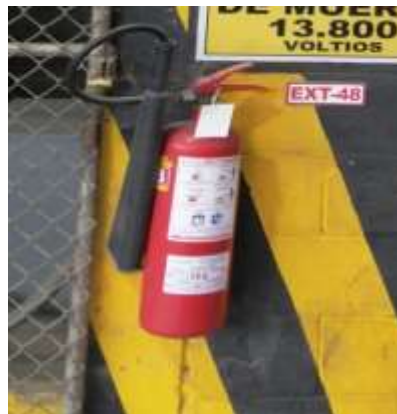
Foto 20. Extintor contra incendios.
