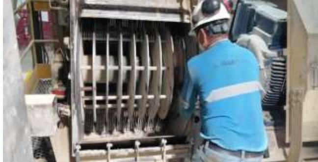
Foto 25. Mantenimiento en un Molino Muyang.
