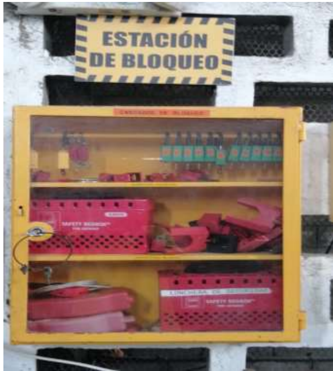
Foto 9. Estación de Bloqueo.
