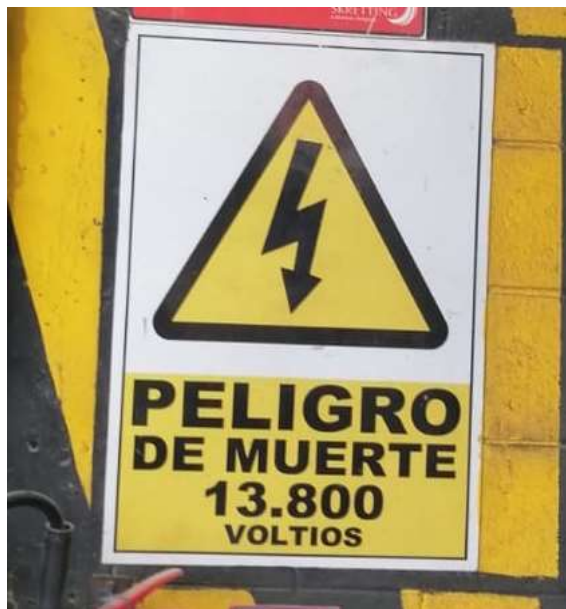
Foto 33. Señalización de Peligro.
